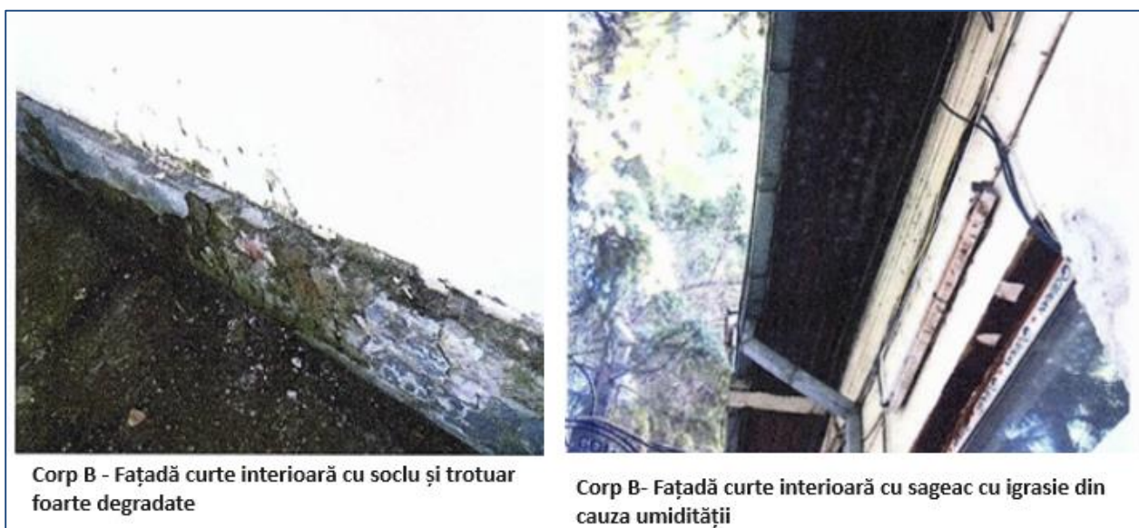
Figura nr. 5. Degradări ale elementelor exterioare
