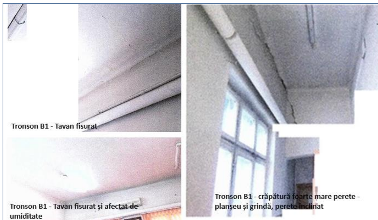
Figura nr. 6. Degradări ale elementelor de interior
